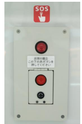
非常通報ボタン
